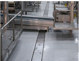
Atık Su Kanalı
